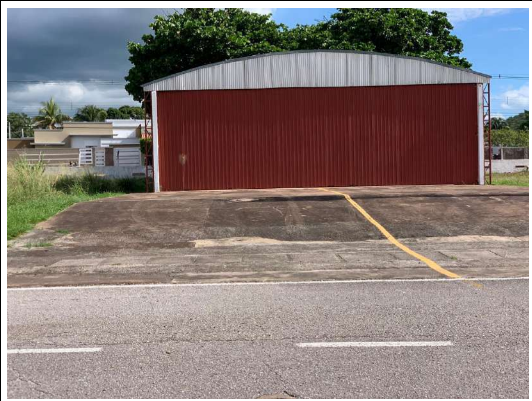
Figura 7: Lado ar, pátio externo (trecho em rampa) e canaleta de drenagem (acervo Infraero)
