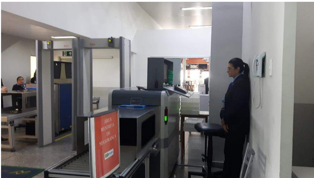
Figura 09 – Equipamentos de Raio X da sala de embarque do TPS SBMK. Fonte: INFRAERO, 2018.
