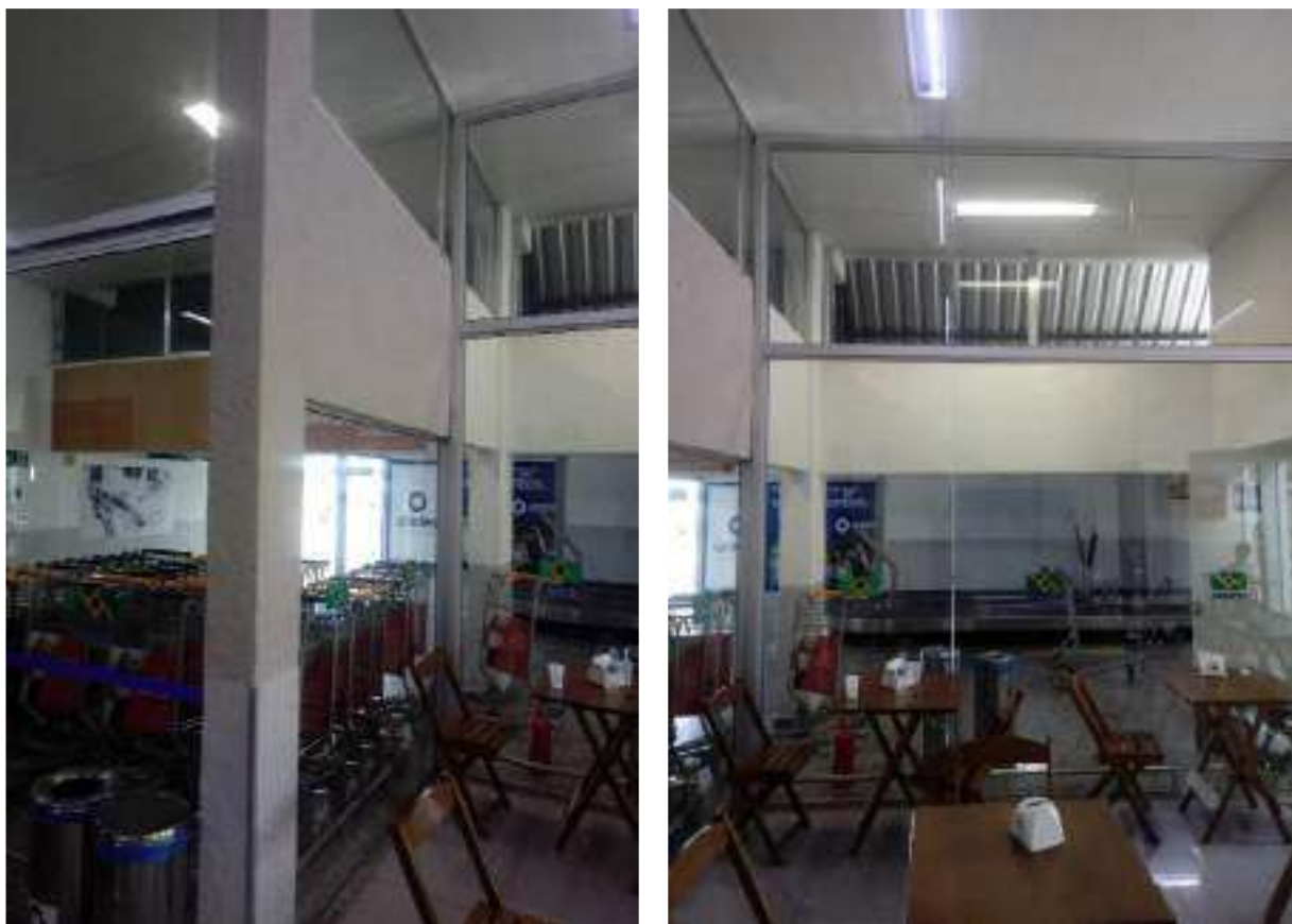
Figura 3 - Vistas externas da sala de desembarque e pela praça de alimentação. Notar vigas de grande altura, instaladas a baixa distância do piso acabado, suportando apenas fechamento em vidro.
