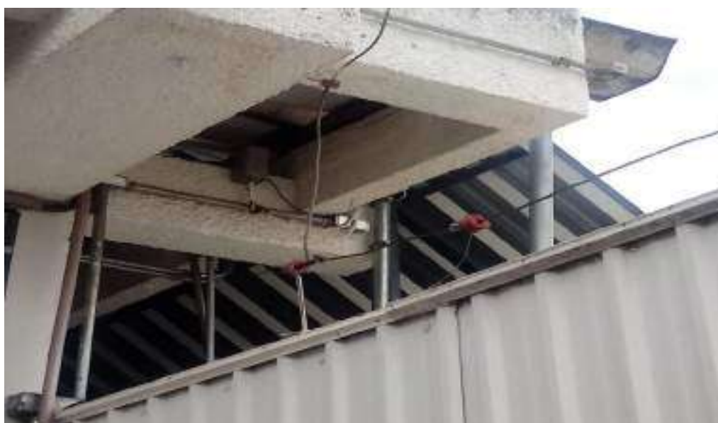
Figura 6 - Detalhe dos apoios da vigas de contorno para suporte do telhado. As vigas mais largas funcionam também como calhas. Nestas, notar o contorno da infiltração pelo fundo da viga calha (assinalado pela seta).
