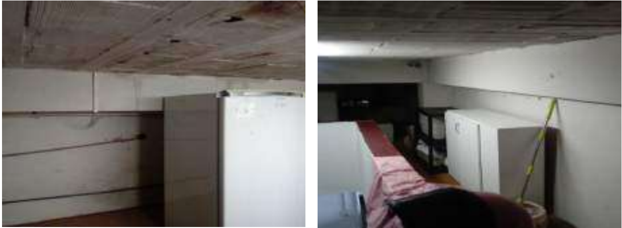
Figura 10 - Região da sobreloja da lanchonete. O pé direito dessa sobreloja não chega a 1,70 m, impossibilitando o caminhar adequado.
