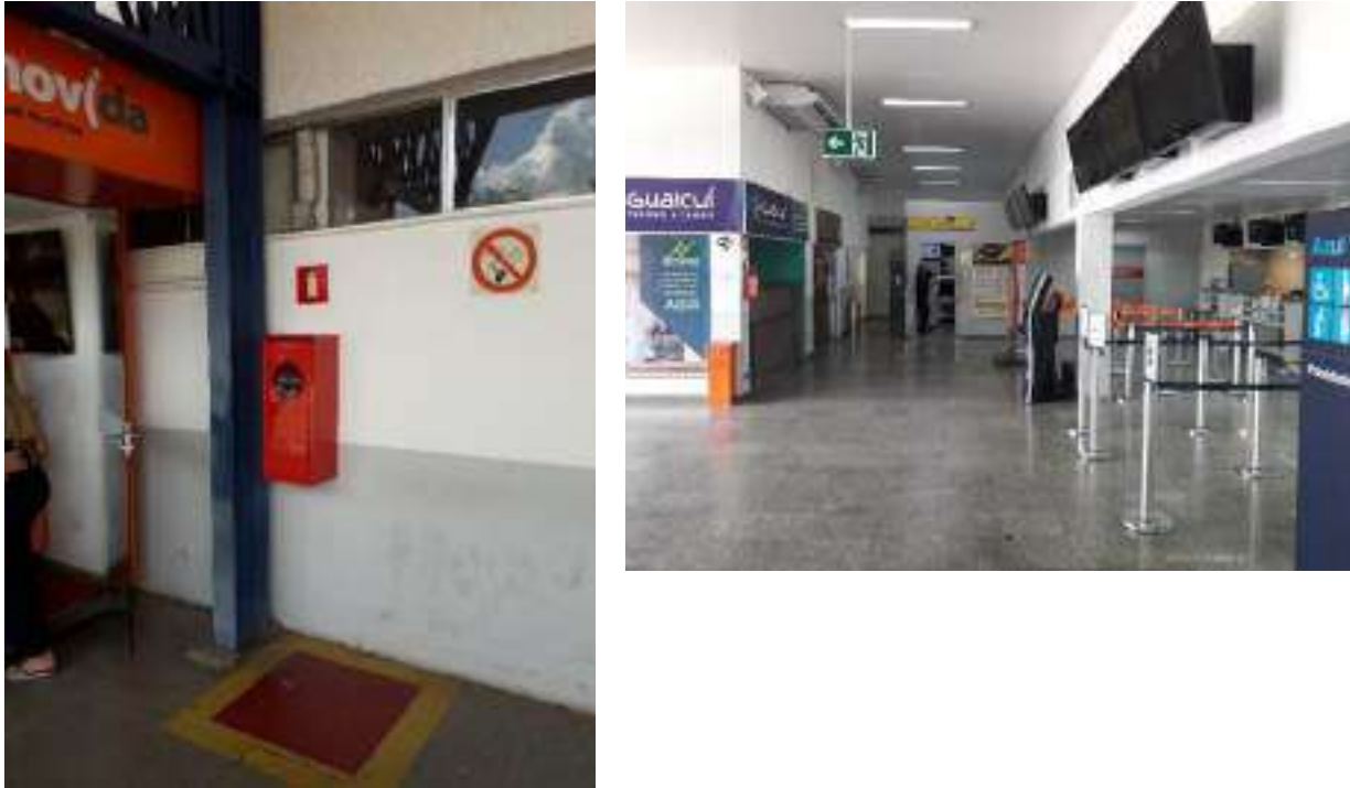
Figura 03 – Sistema existente de Combate a Incêndio (Por Extintores) – Externo e Interno do TPS (Março/2019).
