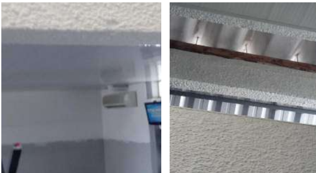
Figura 2 - Teto da sala de desembarque, região da esteira e detalhe da parte superior à viga de contorno. Vazio entre forro de PVC e telha em fibrocimento.
