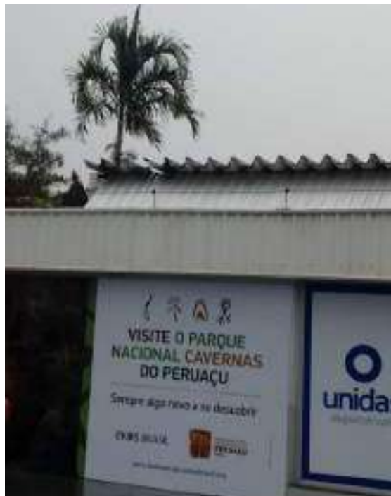
Figura 12 Lado ar. Notar que ausência de uma telha na região do beiral e sua vizinha quebrada. Esta situação é comum nesta cobertura, fora as trincas e furos em grande número nas demais telhas..
