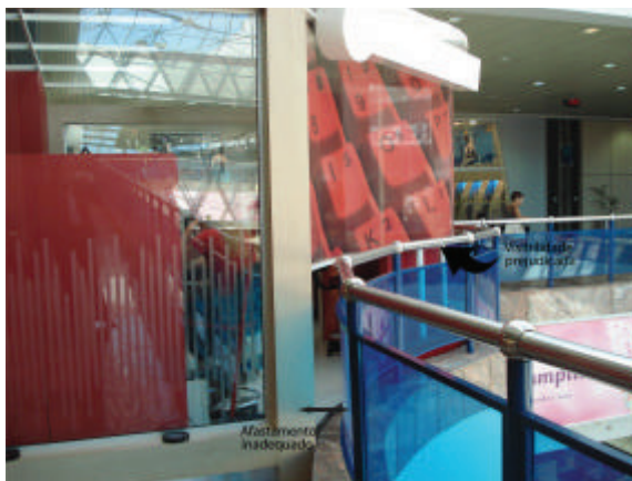
EXEMPLO DE QUIOSQUE ENCOSTADO, INADEQUADAMENTE, NO GUARDA-CORPO.
