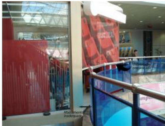
EXEMPLO DE QUIOSQUE ENCOSTADO, INADEQUADAMENTE, NO GUARDA-CORPO.
