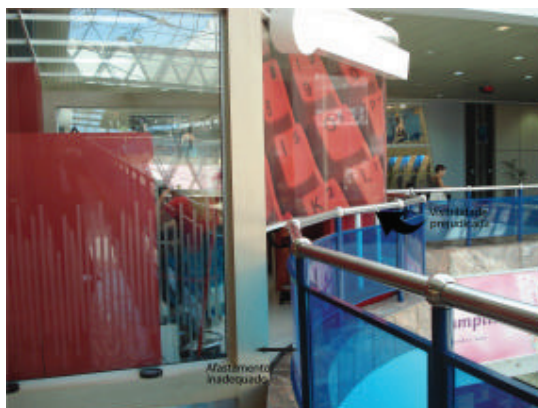
EXEMPLO DE QUIOSQUE ENCOSTADO, INADEQUADAMENTE, NO GUARDA-CORPO.
